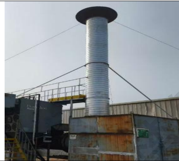
现有弧焊废气排气筒
