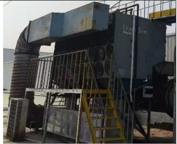
现有弧焊废气处理设施（滤芯除尘）
