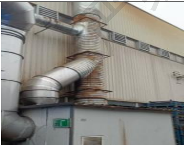
新增弧焊废气+激光切割废气排气筒
