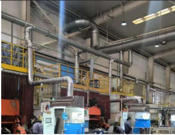
现有弧焊废气收集装置
